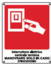
Interruttore elettrico centrale termica MANOVRARE SOLO IN CASO D'INCENDIO 20149 X
